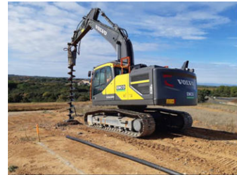
4 Puits verticaux biogaz
