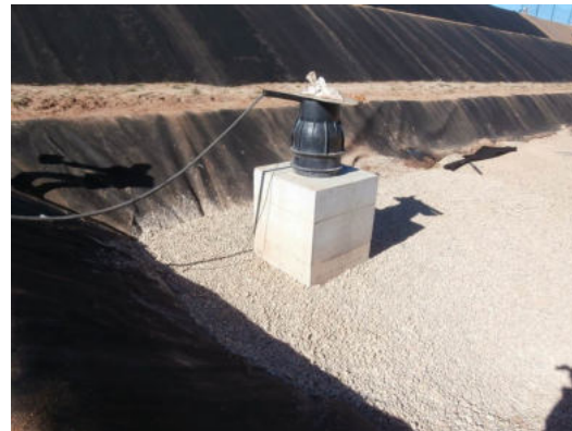
Puits de lixiviats
